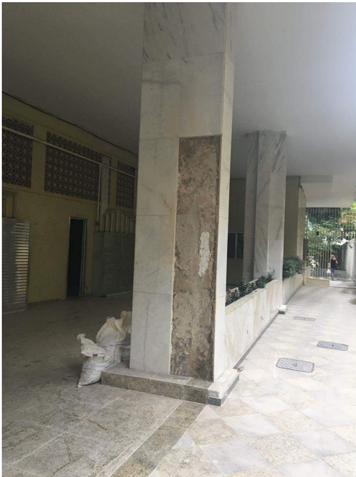
Figura 75 – Devido a retirada da mureta existente, tivemos que repor 03 pedras mármore branca
