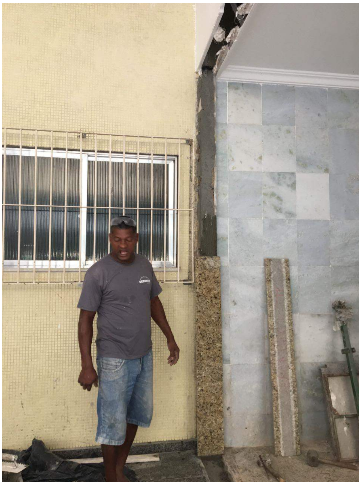
Figura 59 – Início da colocação das pedras de mármore para o acabamento final do vão
