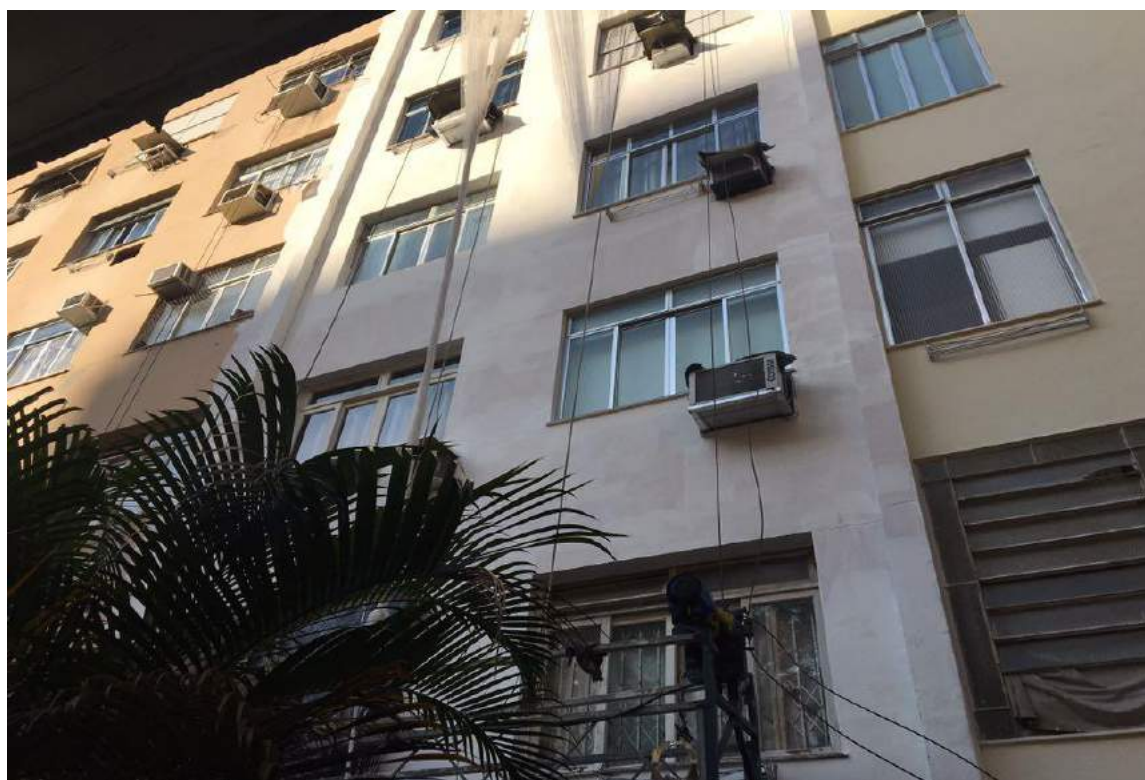
Figura 24 - Aplicação do selador após serem realizadas as devidas recomposições do revestimento em argamassa
