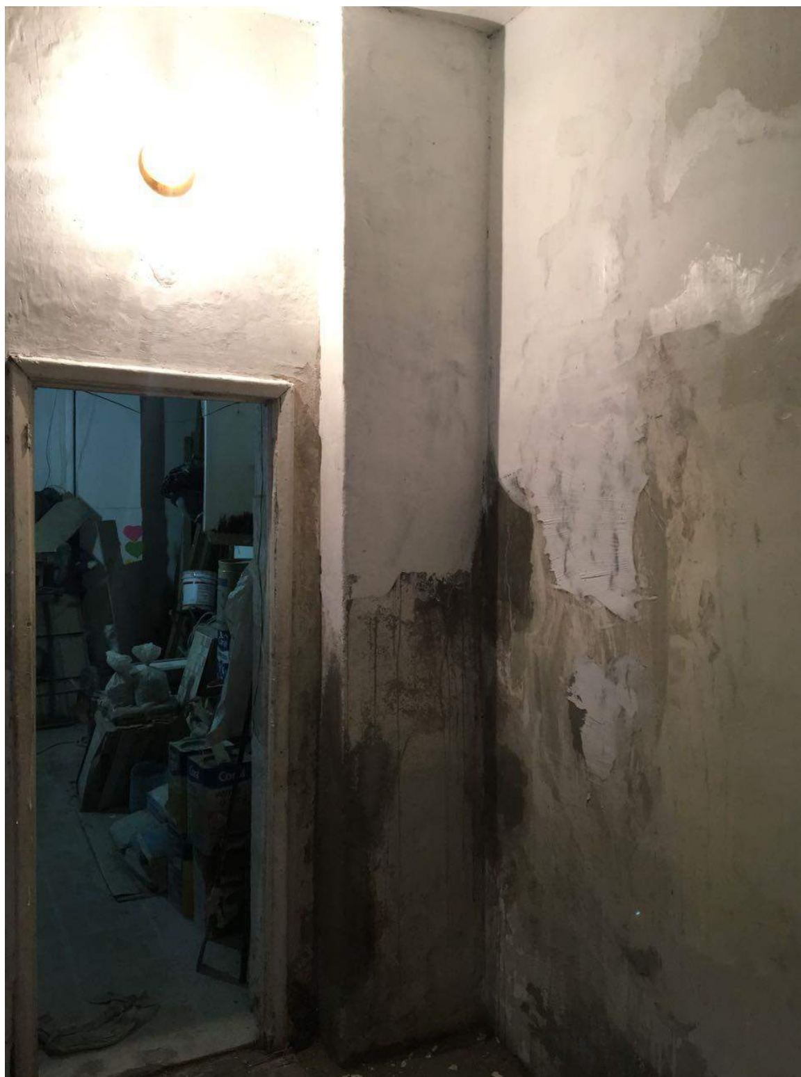
Figura 152 – Quarto da casa de porteiro antes do serviço de restauração
