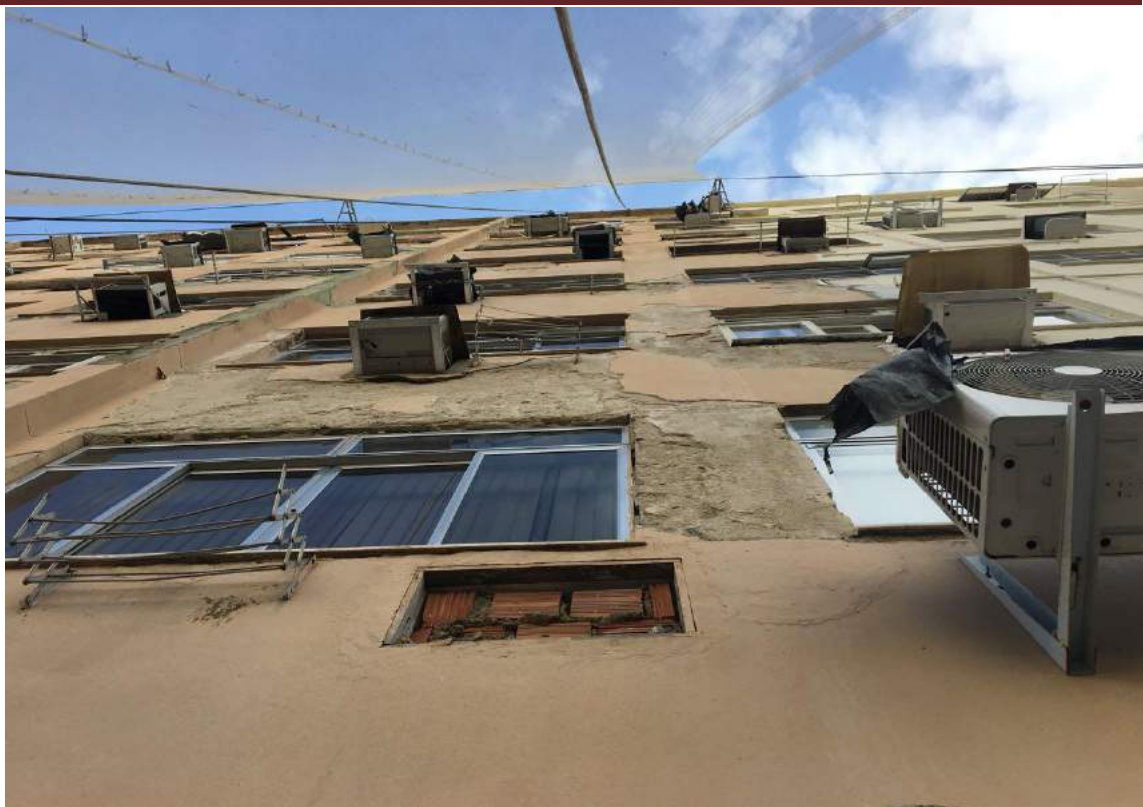
Figura 8 – Detalhe para a grande quantidade de revestimento de argamassa retirado da fachada lateral direita
