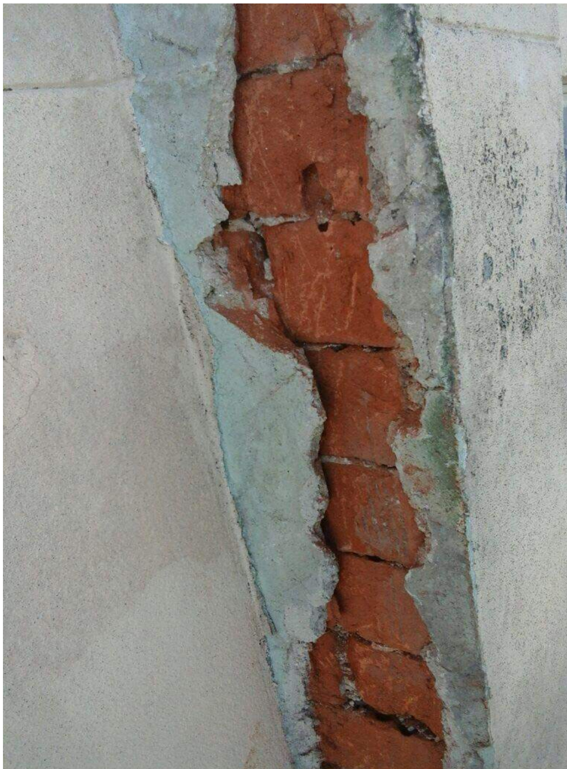
Figura 7 – Detalhe da retirada do revestimento de argamassa mal aderido até a alvenaria
