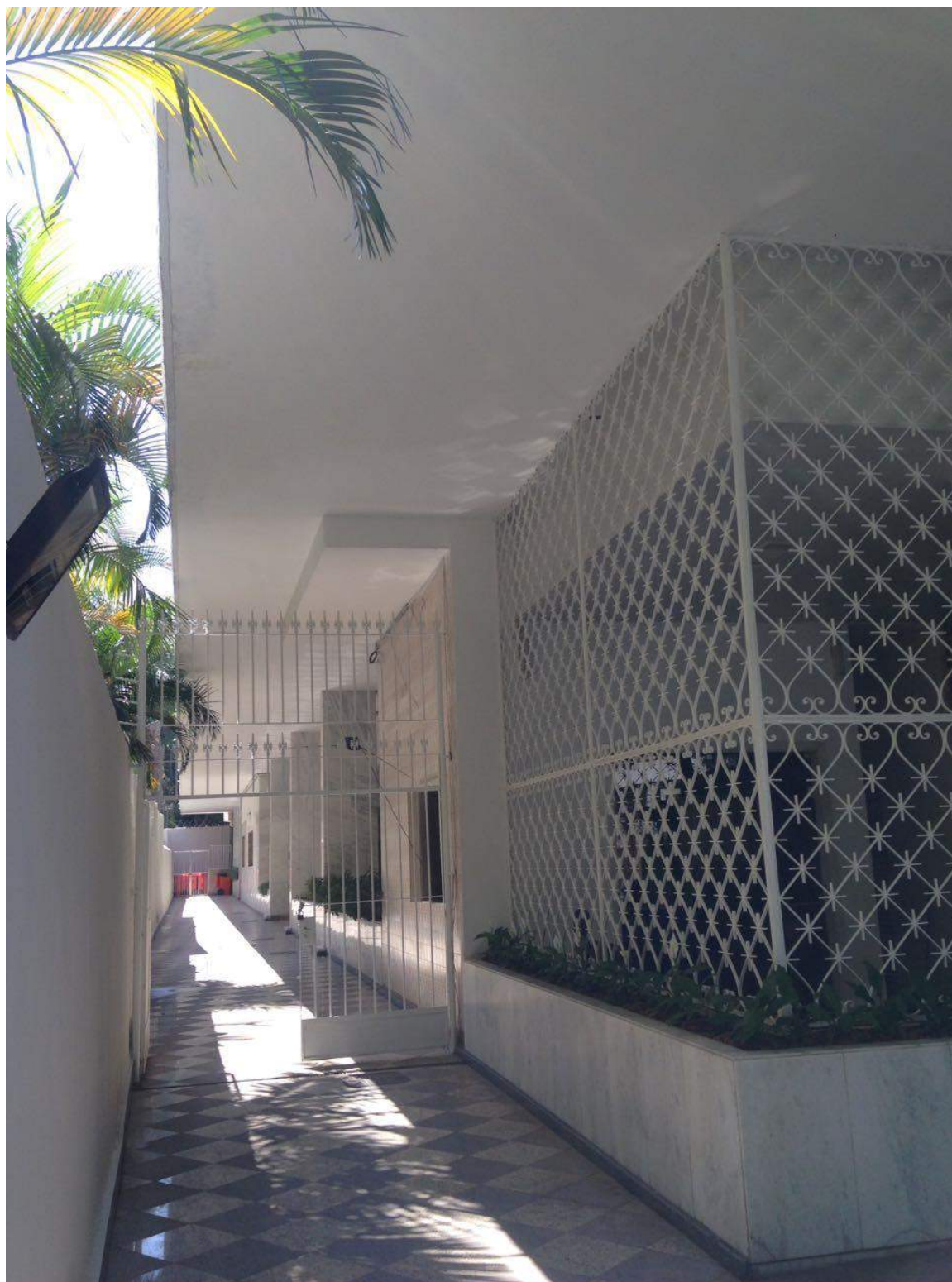
Figura 173 – Conclusão da pintura das grades da entrada e do portão metálico do Condomínio do Edifício Solange
