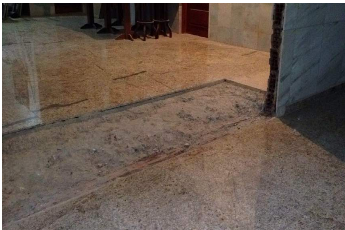
Figura 56 - Detalhe para a rampa sem acabamento
