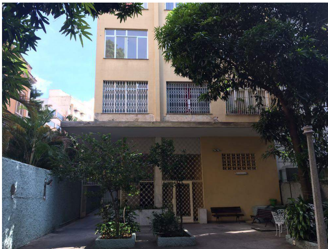
Figura 77 – Situação inicial da fachada frontal e da portaria antes do serviço da construtora
