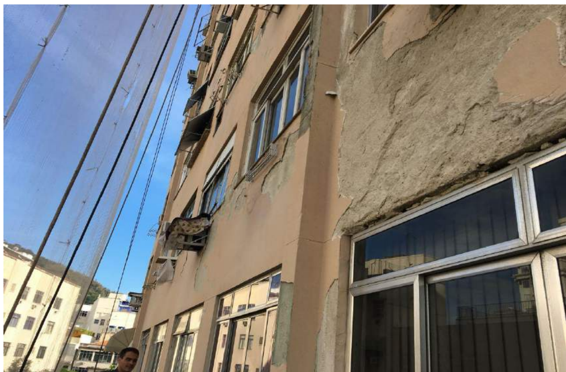
Figura 13 – Visão geral da situação de degradação do revestimento de argamassa encontrada na fachada lateral direita do Condomínio do Edifício Solange
