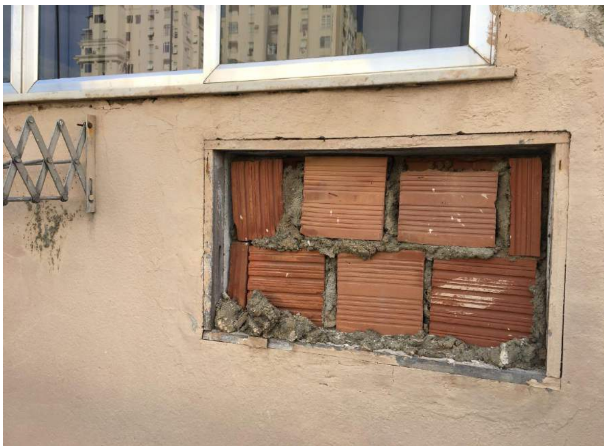
Figura 16 – Fechamento de vão de ar-cond. de forma inadequada
