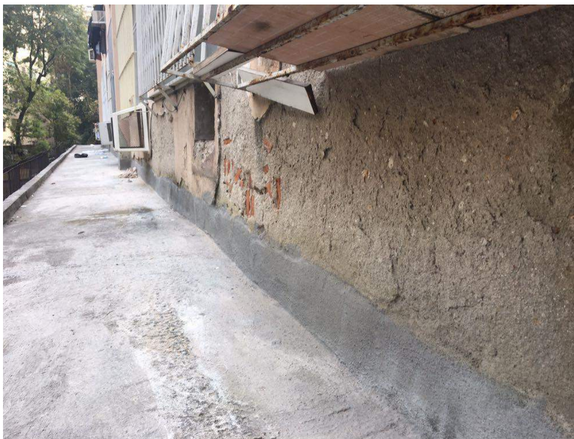
Figura 21 – imagem do estado degradado do revestimento da fachada lateral direita logo acima da marquise
